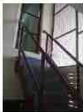
บันไดหนีไฟ
